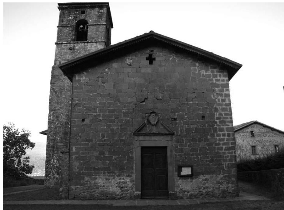
Facciata della chiesa di S. Maria: è evidente la sottofondazione del muro per l'abbassamento del terreno adiacente.
